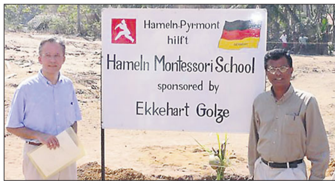
17. Februar: Der Grundstein ist gelegt, das Bauschild aufgestellt. Ekkehart Golze hat symbolisch eine Kokosnuss gepflanzt. Rechts: Mr. Mendis von der Fa. Rileys, die an „ogos“ Kokosmatten liefert.
